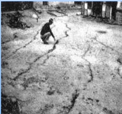
永康鄉三民村10號民宅前之地裂，屋後之地裂裂口深度達18公分，2.5公尺長，走向呈NNW-SSE。(根據徐明同與呂新民，1969)
