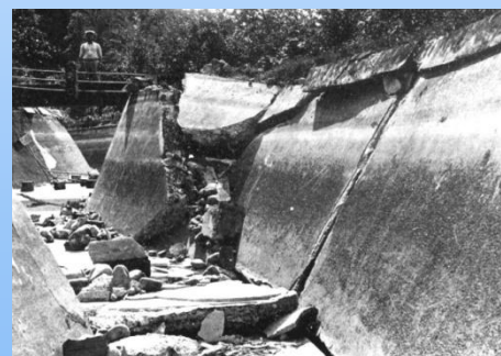
后里埤的破壞，導致3,300甲稻田缺水灌溉，破裂處有明顯的水平錯位。
