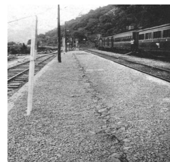
大安(泰安)火車站月台上之龜裂線
